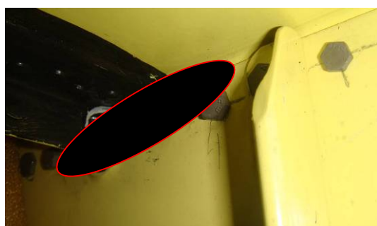
a 左侧上壁板与第42框连接处航向筋条断裂
