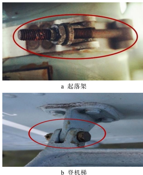
图1 直升机紧固件现场腐蚀照片
