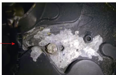
b 螺栓孔周围腐蚀
