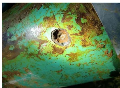
a 单点腐蚀
